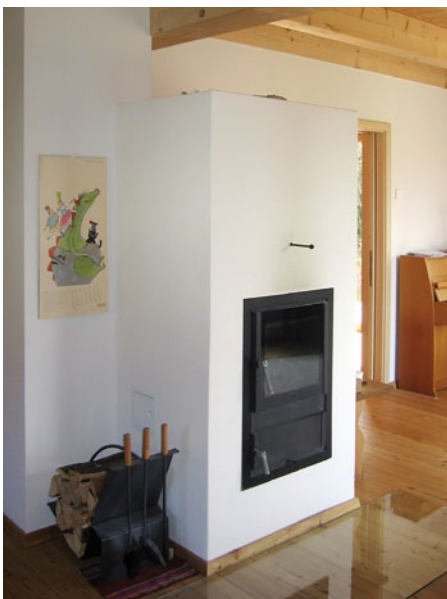
Schlicht und hocheffizient: Der Scheitholzofen als Zentralheizung mit solarer Heizungsunterstützung.
